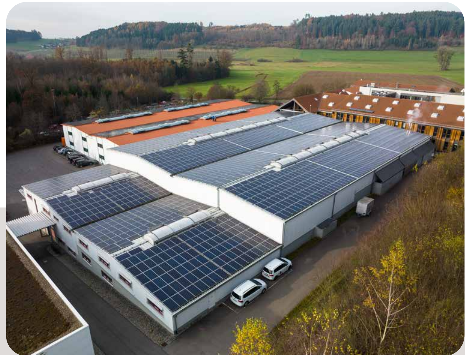
Mit einer eigenen PV-Dachanlage deckt die Firma den Strombedarf am Hauptsitz selbst und ist dort seit 2012 klimaneutral.
